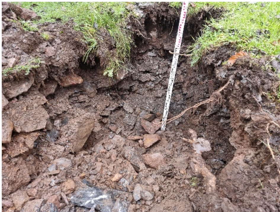
PM3 : blocs de roche . parois instables
