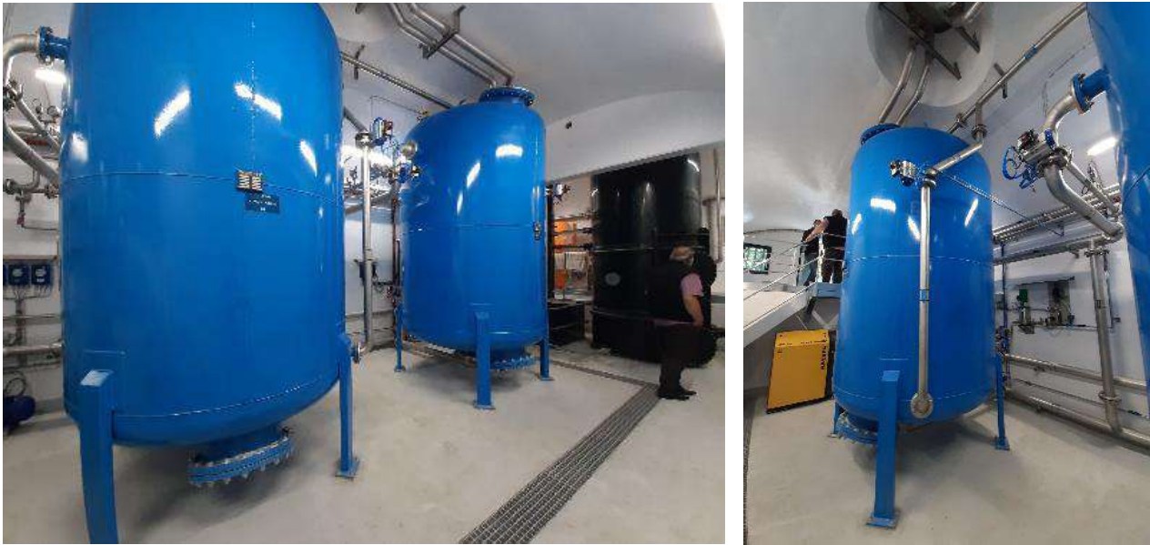
Figure 30 : Filtres de reminéralisation, station de traitement de Kirchberg (68)
