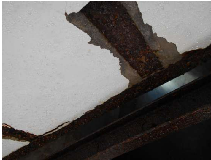
Figure 17 : Poutrelles apparentes et fortement corrodées
