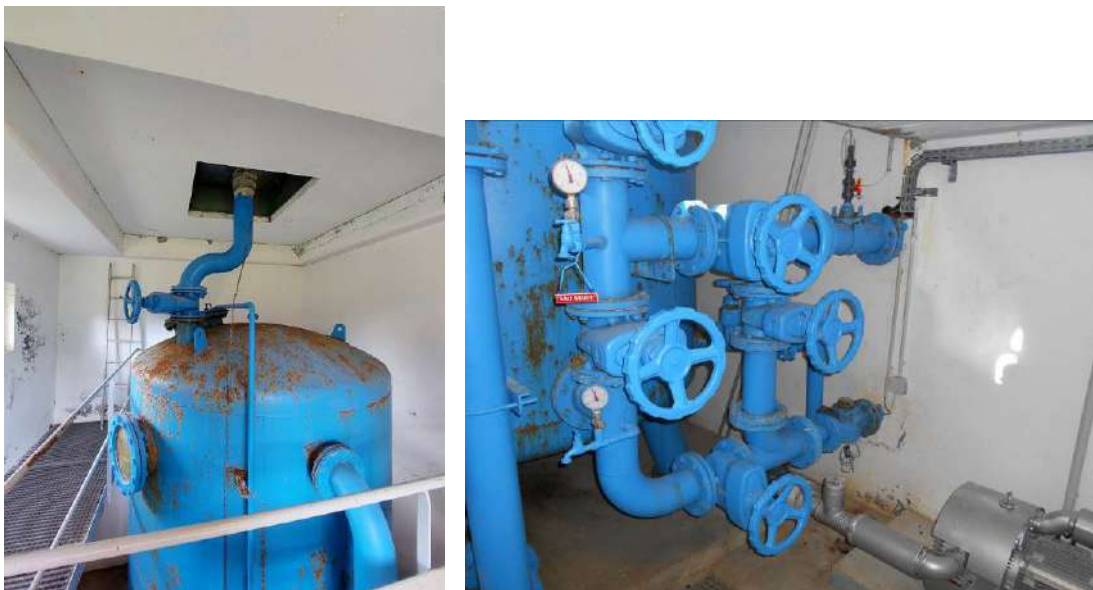
Figure 20 : Photos du filtre et des équipements hydrauliques fortement corrodés
