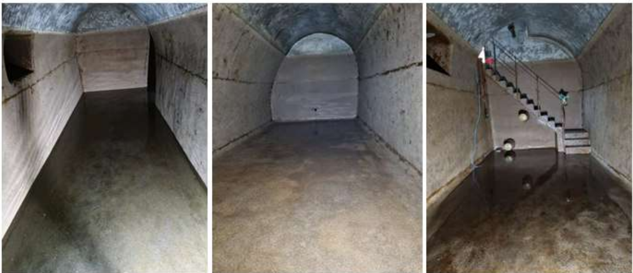
Figure 16 : Photos intérieures des cuves et absence d'étanchéité
