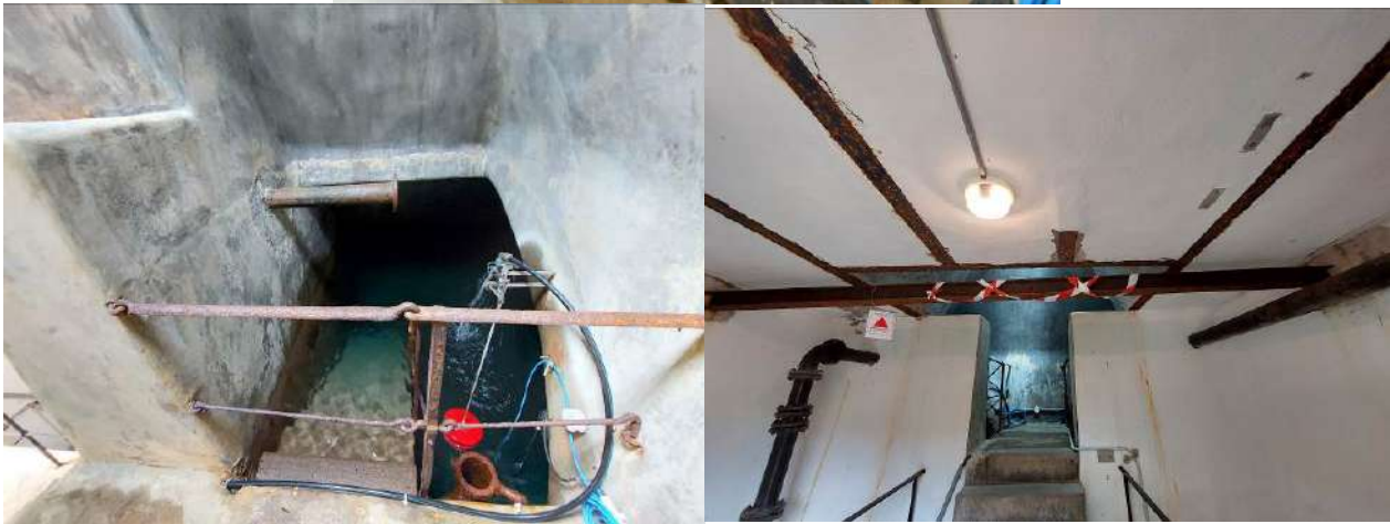
Figure 15 : Photos de la chambre à vannes
