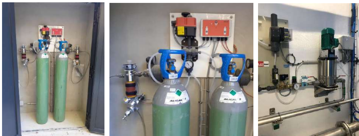
Figure 27 : Système d'injection de CO 2 , station de traitement de Kirchberg
