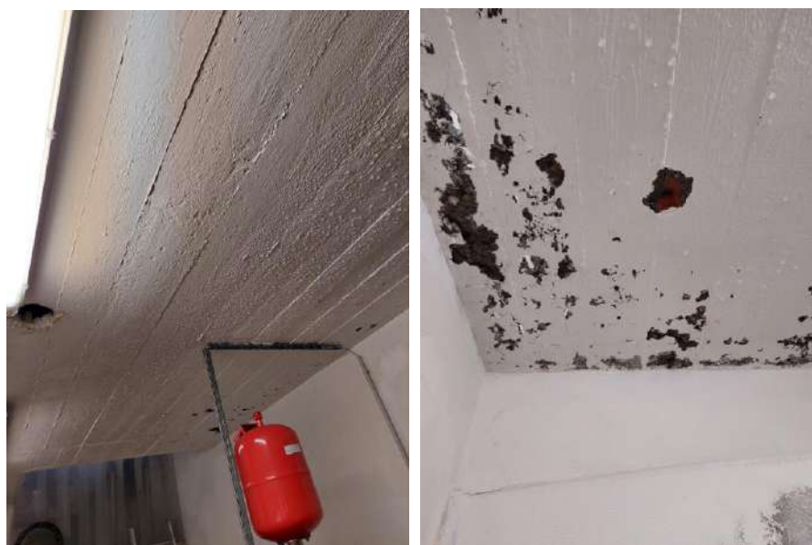
Figure 35 : Humidité dans la chambre à vannes (rez-de-chaussée)
