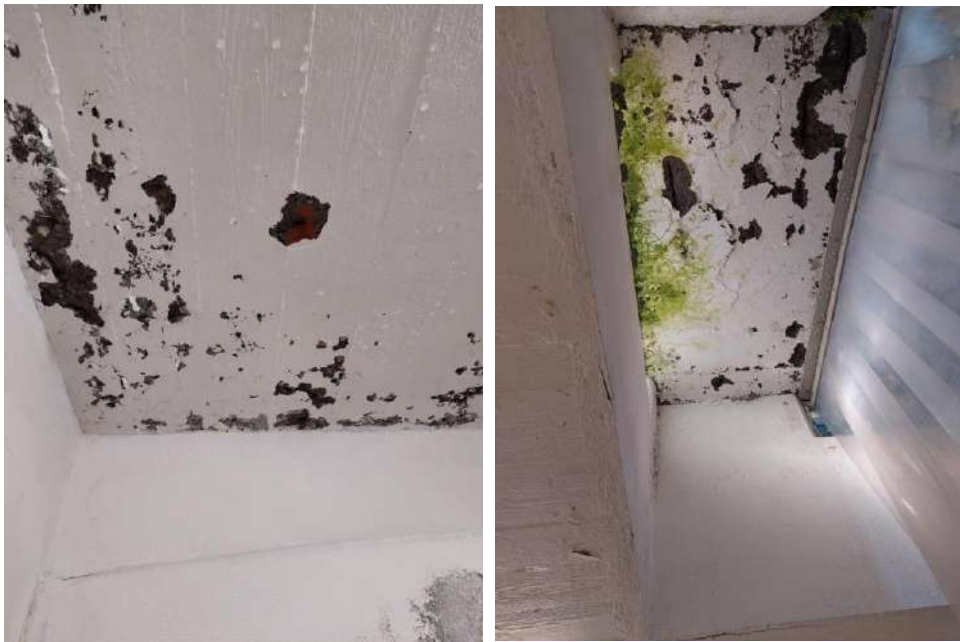
Figure 16 : Zones du plafond dégradées
