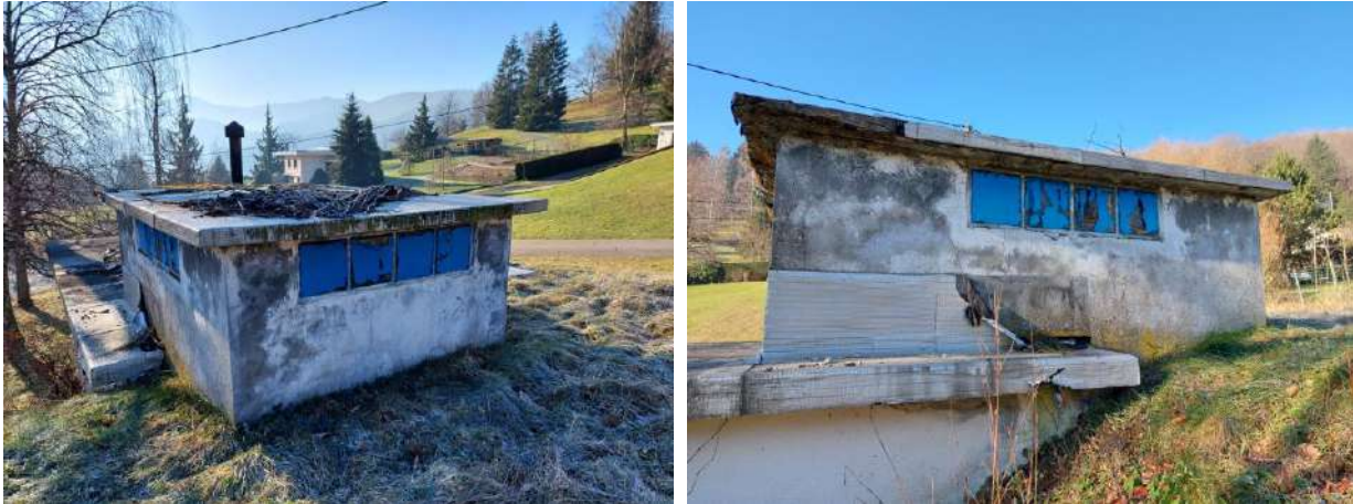
Figure 33 : Lanterneau à reprendre
