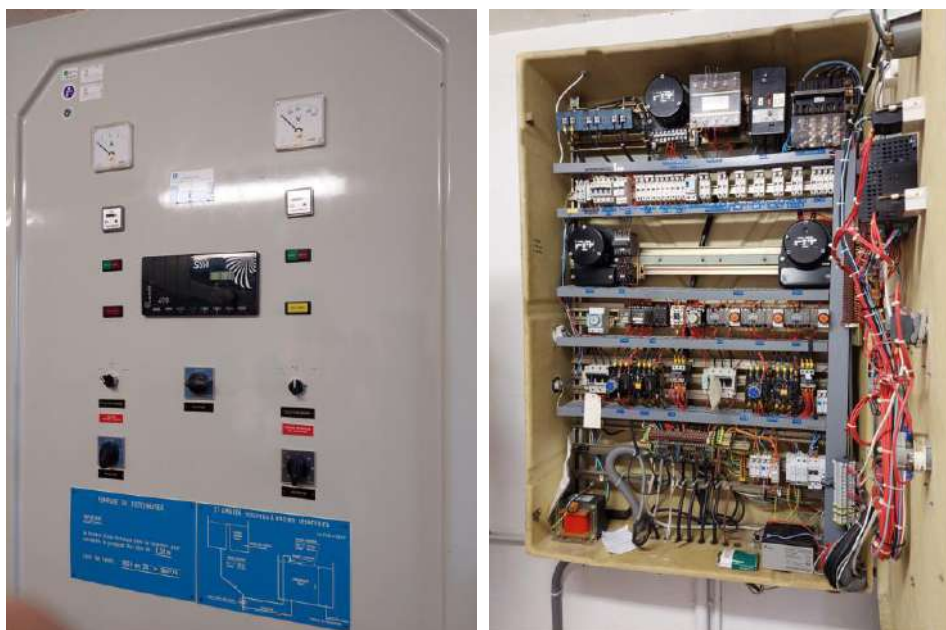
Figure 19 : Armoire de commande
