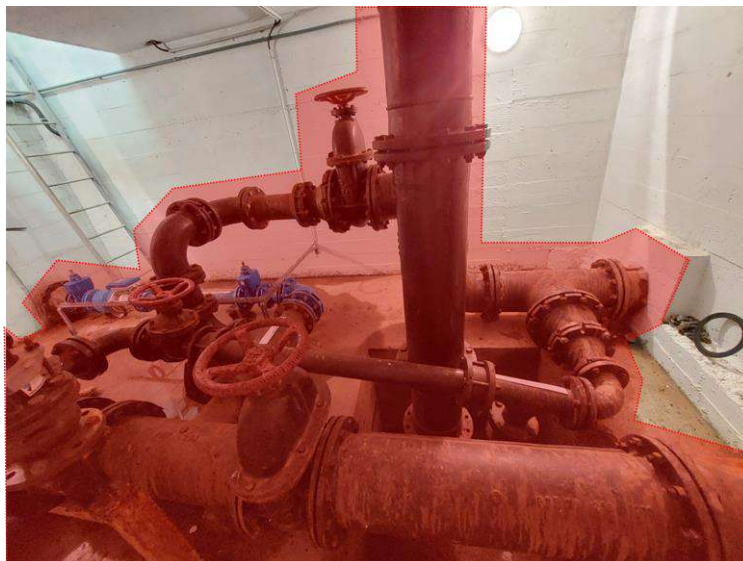
Figure 27 : Eléments existants de la chambre à vannes à déposer
