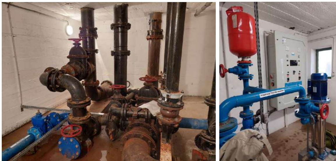
Figure 17 : Etat des conduites – Chambre à vannes
